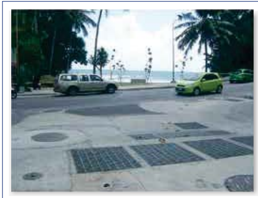
วางท่อเสร็จ ปิดผิวถนนพร้อมใช้งาน (ท่อ PROPIPE สามารถรับแรงกดทับ) ได้ถึง 10 ตัน/m 2 จึงไม่มีปัญหาเรื่องถนนยุบหรือท่อหักกลางเนื่องจากดินทรุดตัว
